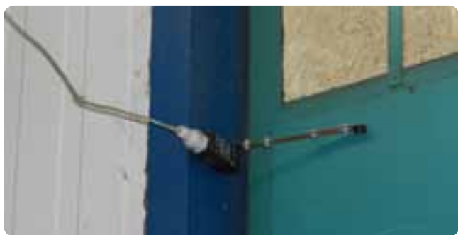
Obr. 3 Snímače otvorenia sú nainštalované na každej vstupnej bráne
