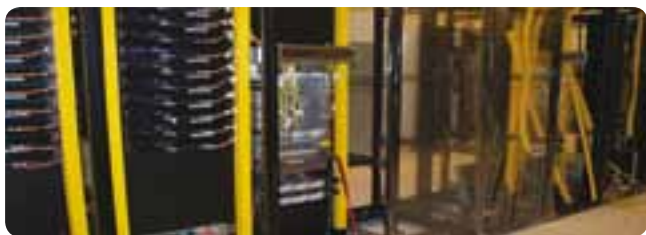
Typické dátové centrum Google
